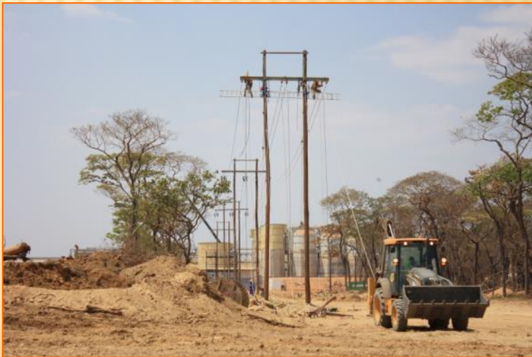
33KV SITE POWER 02-SEPT-2013
